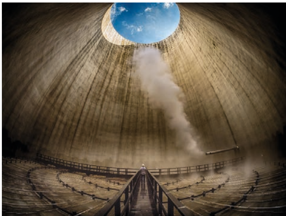
Interno della torre di raffreddamento
